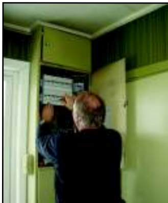
Registrerte Elektriske installatører.
