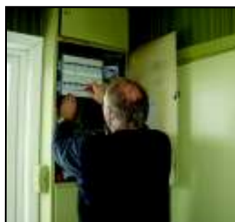
Registrerte Elektriske installatører
