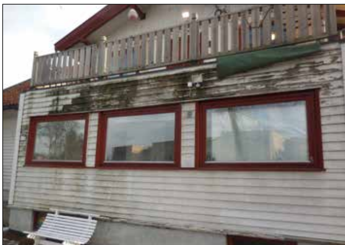
Utvendig er forfallet godt synlig.
