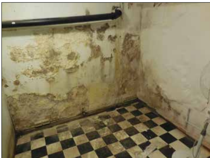
Fuktskadene i kjelleren er også godt synlige.
