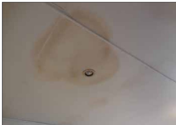
Mange steder inne kan man se fuktsakder i taket.
